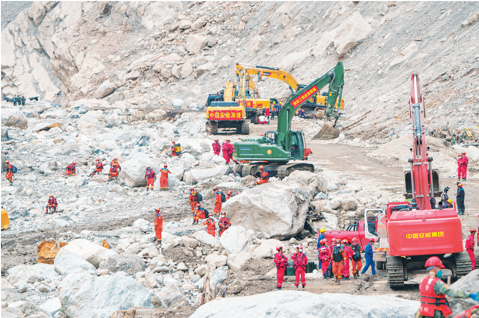
▲这是 9 月 2 日拍摄的吉隆泥石流灾害核心区搜救现场。 新华社记者丁增尼达 摄
