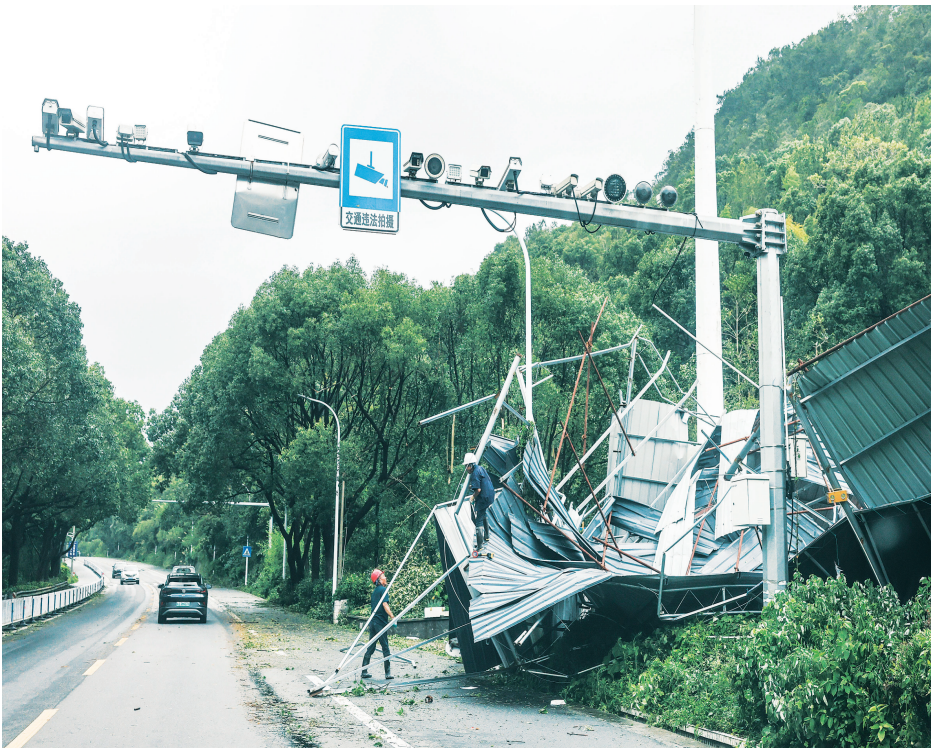
▲7月12日，在浙江台州温岭通往玉环的省道旁，工作人员清理被台风刮倒的建筑。 新华社记者徐昱 摄
