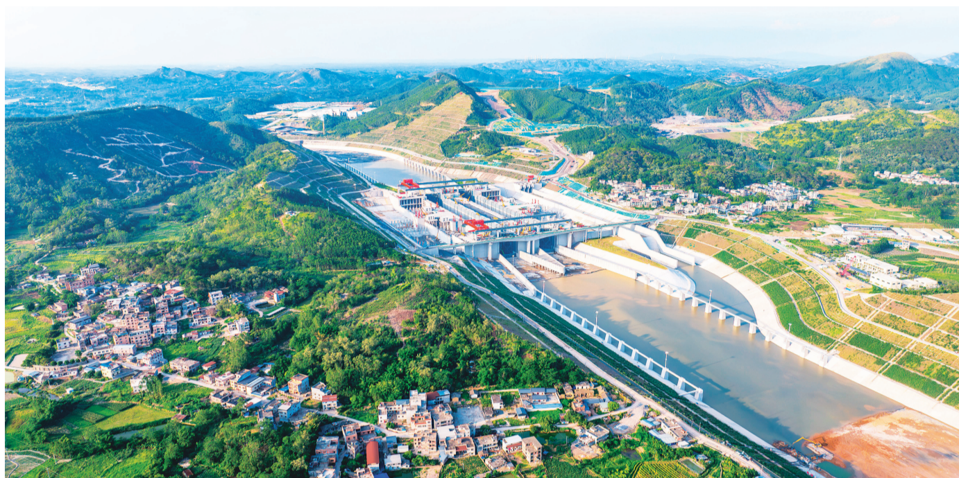
▲这是6月3日拍摄的广西平陆运河马道枢纽充水现场(无人机照片)。 新华社发
