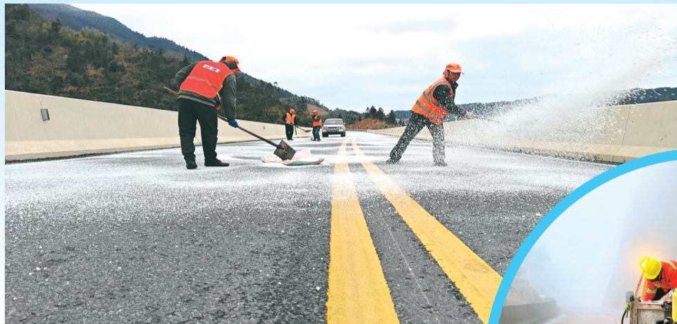
兴安公路养护中心工作人员在省道501线罗家塘大桥除冰作业。 通讯员唐萍 摄
