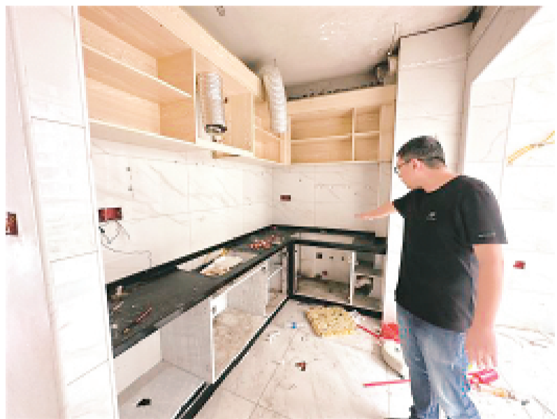
戚先生收房时，发现厨房里面的装修被破坏得比较严重。
