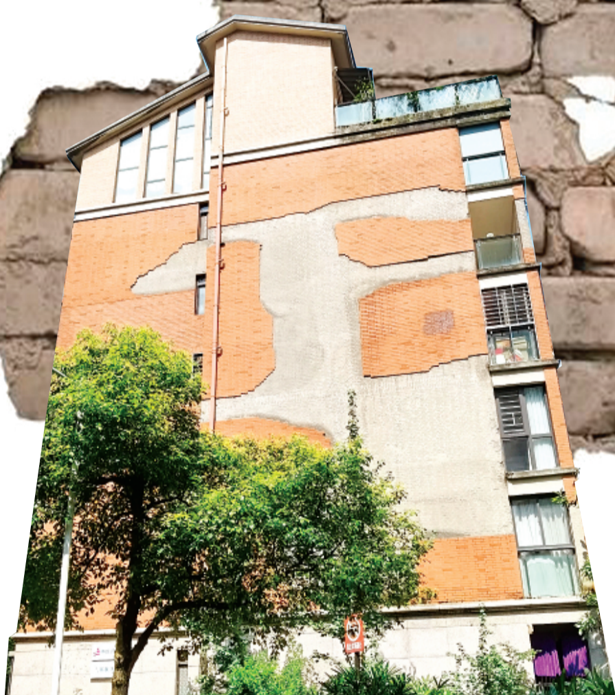
↑ 大面积脱落的外墙。
