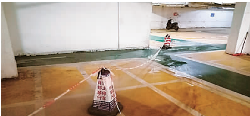
一栋2单元地下车库积水处拉起警戒线。
