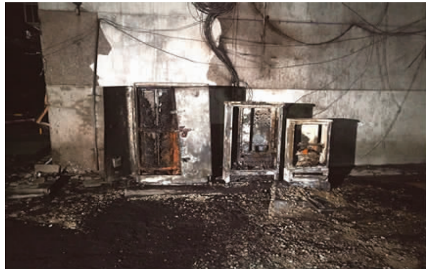
事发的25栋楼旁，3个通讯设备箱和线缆均被烧毁，现场一片焦黑。
