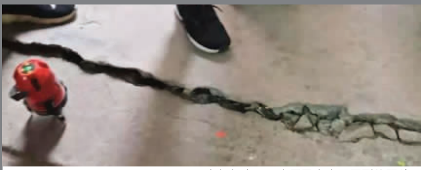
去年年底,一户居民家房子开裂的照片。
