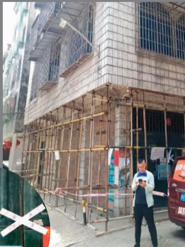
↑危房周围已张贴警示并进行临时加固。
