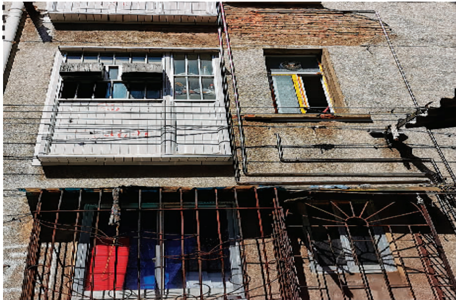
民族里10号一栋居民楼外墙有脱落现象，网格负责人已经申报修复。记者刘净伶 摄
