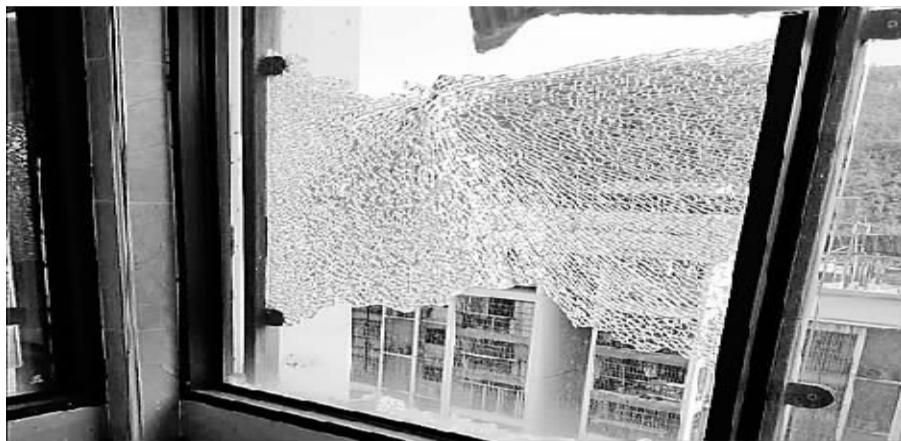
玻璃爆裂后，剩下部分摇摇欲坠。
