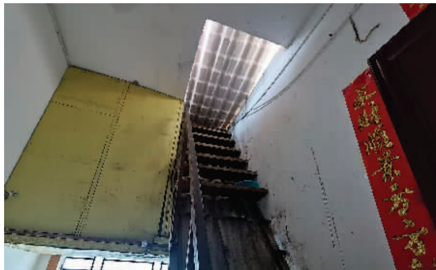
楼梯间顶层被开“天窗”遇雨天漏水。
