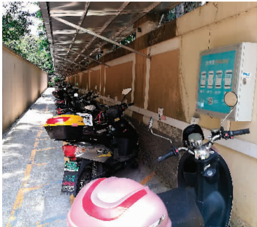
安厦世纪城内的电动车充电桩。
