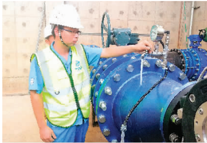
在花江校区供水工程第一加压泵站,工作人员正在检测水压。
