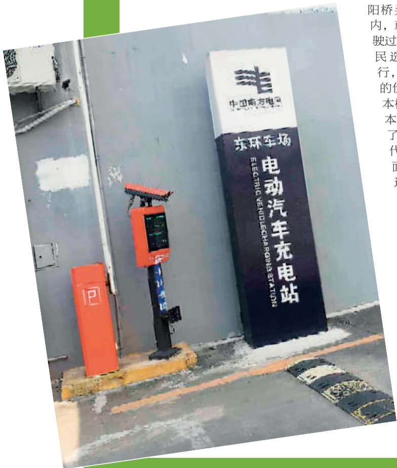
◀一个新能源汽车充电站。 见习记者 赖伊婷 摄
